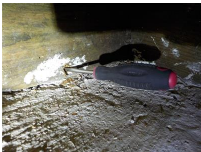
Rötskador i syll vid källartrappan, inga förhöjda fuktvärden.
