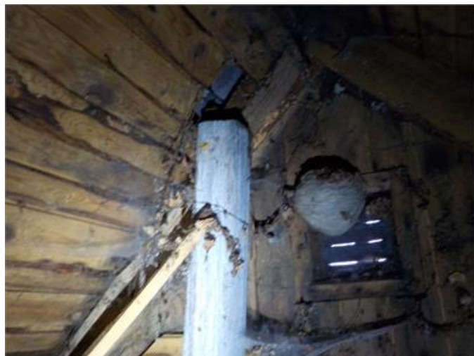
Ventilationskanal avslutas nedanför öppning i underlagstak.
