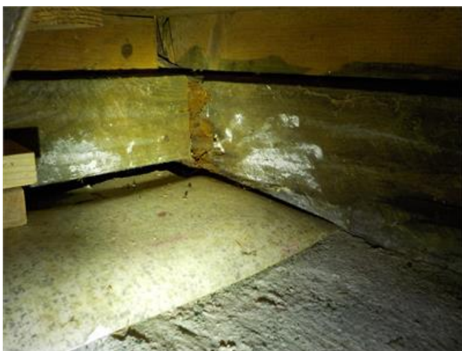
Rötskador i syll vid källartrappan, inga förhöjda fuktvärden.
