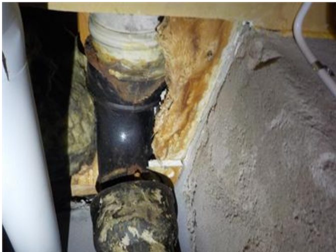
Pannrum/förråd: Brister förekommer i taket efter tidigare läckage.
