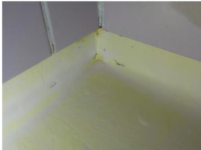
Källardusch: Mindre brister/sprickor i plastmattan.
