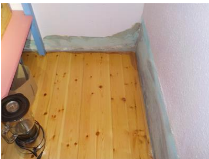
Matkällare: Färgsläpp på nederdel väggar och missfärgningar i anslutande parkett.
